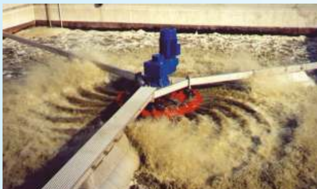
SBR-Kläranlage Gemeinde Krzyz, Polen
