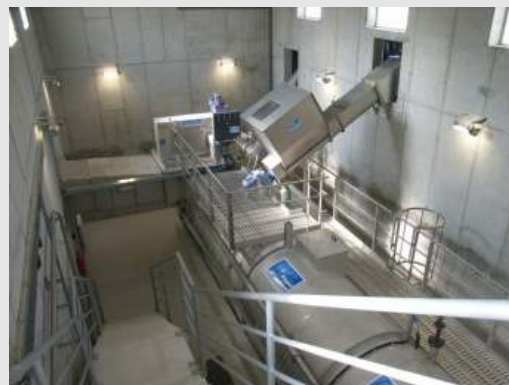
Vorklärstation der Kläranlage Koprivnica (max. hydraulische Leistung = 1.600 m 3 /h).
