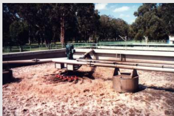
BSK®-Oberflächenbelüfter der SBR-Kläranlage der mexikanischen Stadt Celaya.
