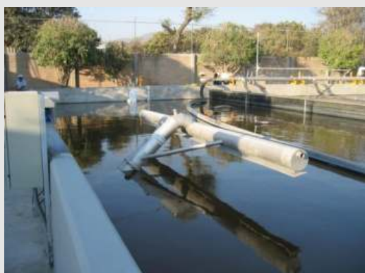
BSK®-Klarwasser-Dekanter installiert in einer Kläranlage in Mexiko
