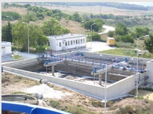
Biogest-Kläranlage von der bulgarischen Stadt Beloslav (20.000 EW).
