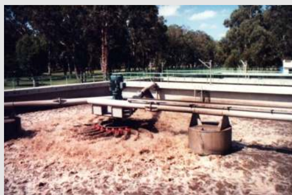
BSK®-Oberflächenbelüfter der SBR-Kläranlage der mexikanischen Stadt Celaya.
