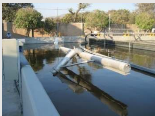
BSK®-Klarwasser-Dekanter installiert in einer Kläranlage in Mexiko
