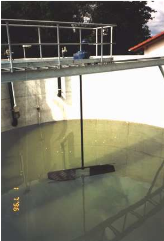
MBR-Rührwerk im Probebetrieb
