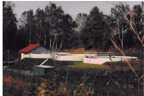
Biogest-Kläranlage der Gemeinde Schönfeld (2.000 EW)
