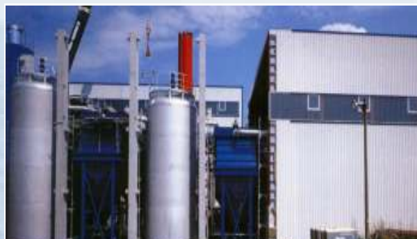
Biologische Kläranlage einer Textilfabrik mit Anwendung von Herdofenkoks als biogenes Trägermaterial.
