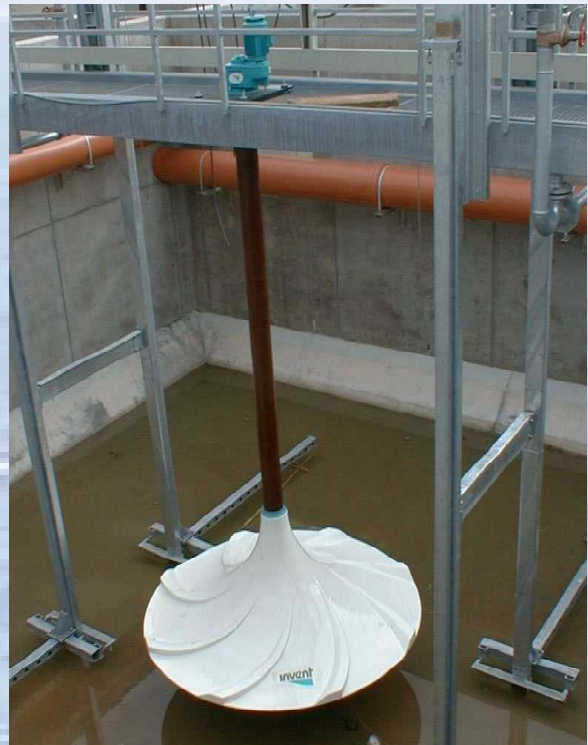
Abbildung Nr. 8: Installation eines HYPERCLASSIC ® -Rührwerks in einem Belebungsbecken, welches intermittierend (Nitrifikation und Denitrifikation) betrieben wird. In diesem Projektfall werden Membranbelüfter zur Begasung verwendet. Deutlich zu sehen sind die vorbereiteten Schlauchmodule im Hintergrund des Rührwerks.
