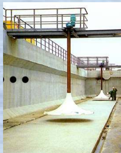
Abbildung Nr. 3: Zwei HYPERCLASSIC ® -Rührwerke in einem Detrifikationsbecken. Das typische Design und die Einfachheit der Installation wird aus dieser Darstellung besonders deutlich.
