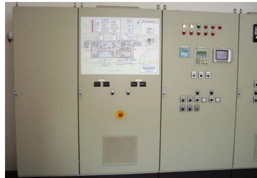
Ansicht eines Elektroschaltschranks
