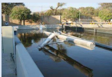
BSK®-Klarwasser-Dekanter einer Kläranlage in Mexiko
