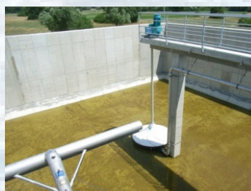
HyperClassic-Begasungssystem installiert auf einer Betonbrücke. Im Vordergrund befindet sich ein BSK®-Dekanter.
