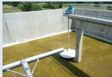
HyperClass- Begasungssystem installiert auf einer Betonbrücke. Im Vordergrund befindet sich ein BSK®-Dekanter.
