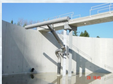
BSK®-Dekanter installiert in einer Kläranlage bei Basel (Schweiz)
