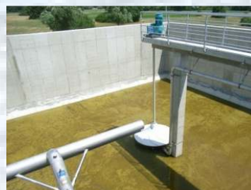
HyperClassic-Begasungssystem installiert auf einer Betonbrücke. Im Vordergrund befindet sich ein BSK®-Dekanter.
