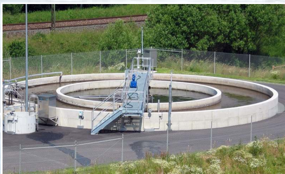
Kombibecken mit Bedienbrücke und lokales Pumpwerk (links)
