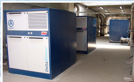
Blick in den Maschinenraum mit den Hochleistungs-Gebläsen und der Edelstahl-Rohrleitungstechnik
