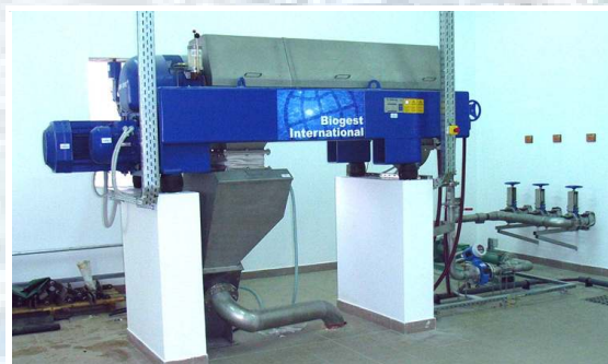
Mit Hilfe einer Hochleistungszentrifuge wird der Überschussschlamm entwässert (20 – 30 % TS).
