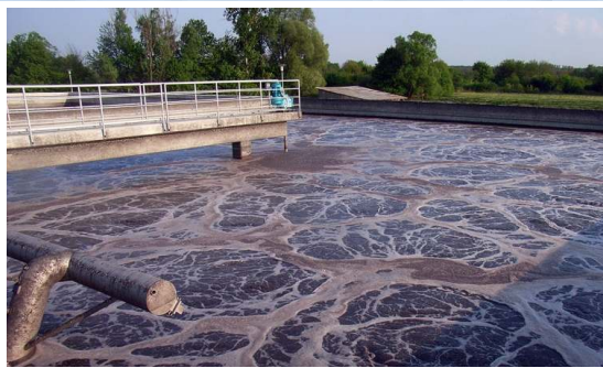
Blick auf einen der vier SB-Reaktoren mit zentral angeordnetem HyperClassic-Rührwerk und den BSK®-Dekanter zum Abzug des Klarwassers.
