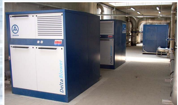
Blick in den Maschinenraum mit den Hochleistungs-Gebläsen und der Edelstahl-Rohrleitungstechnik.
