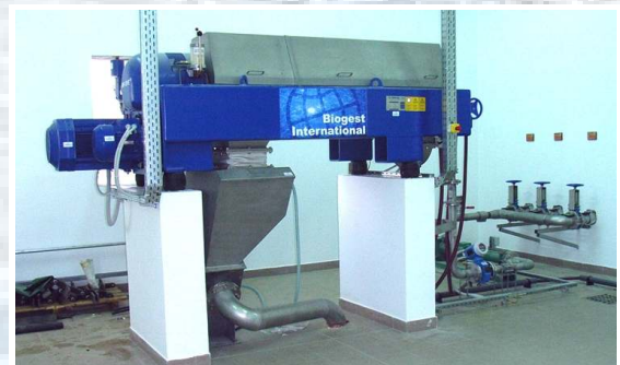
Mit Hilfe einer Hochleistungszentrifuge wird der Überschussschlamm entwässert (20 – 30 % TS).
