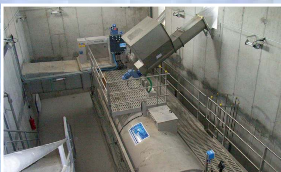
Kompakte Vorklärstation zur Vorreinigung des Abwassers (Feinsieb, belüfteter Sand- und Fettfang). Zur Sandabscheidung wurde der patentierte Walzensandfang angewendet.
