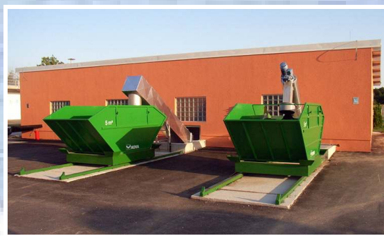
Abwurf von Sand und Feststoffen aus der Vorklärstation. Durch ein spezielles Waschverfahren wird ein Großteil der organischen Inhaltsstoffe in das Abwasser zurückgeführt.
