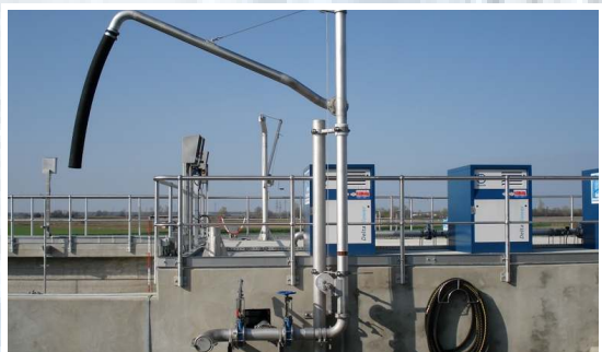
Schlammgalgen zur Entnahme des Dickschlammes aus dem Schlamm-silo
