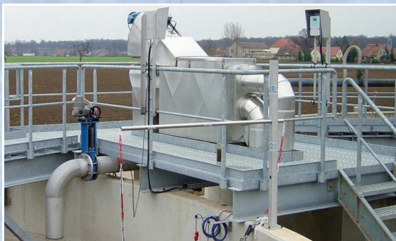
Kompakte Vorklärstation mit Einhausung (Frostschutz)
