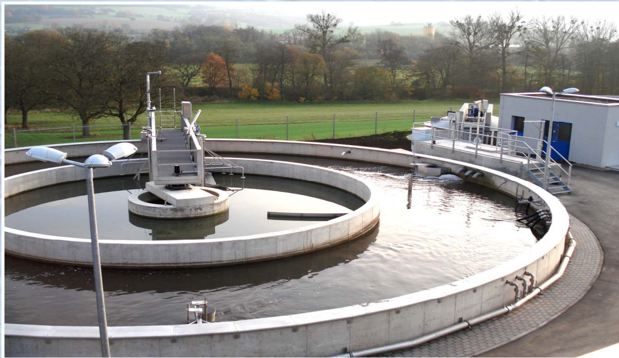
Ansicht der Kläranlage Gersheim mit Kombibecken im Vordergrund, Schlammverdicker und Schlamm-pumpenhaus im Hintergrund
