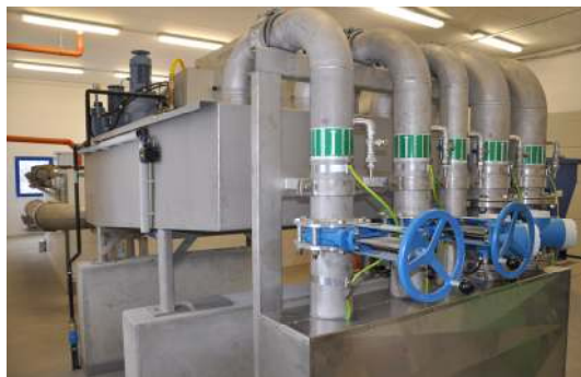
Vorklärstation (Flachfeinsiebrennen) mit Zulaufleitungen
