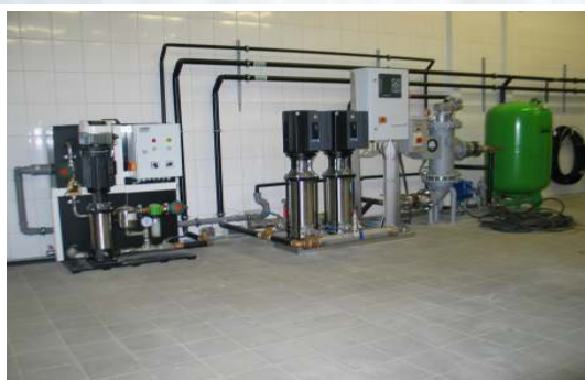
Brauchwasseranlage (Systemtrenner, Druckerhöhung, Filter)
