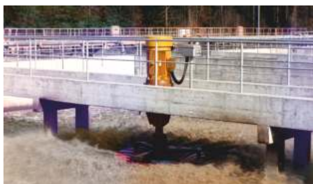
Station d'épuration de la ville de Lucerne, Suisse
