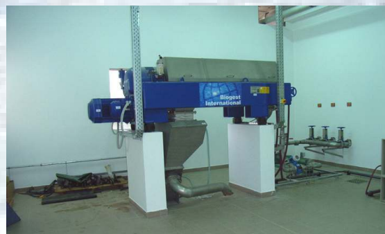
Mulj se dehidrira pomoću visokoučinske centrifuge (20 – 30 % ST-a), za jednostavno zbrinjavanje, odn. daljnju uporabu.
