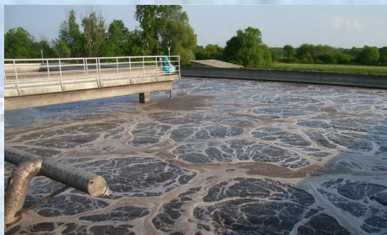
Pogled na jedan od četiri SB-reaktora sa centralno postavljenim HyperClassic-uređajem za miješanje te BSK®-dekanterom za odvod bistre vode.
