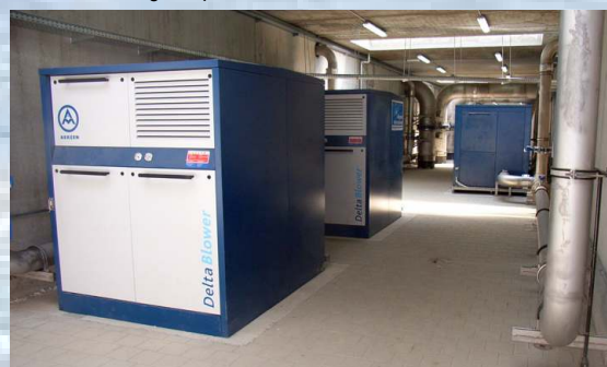
Pogled u strojni dio sa visokoučinskim upuhivačima i cijevnom tehnikom od plemenitog čelika.
