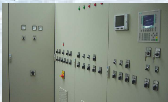
Centralno upravljanje svim tehničkim komponentama vrši se iz uklopnice. Pomoću daljinskog povezivanja moguća je neposredna kontrola svih upravljačkih postupaka. Nadalje su vidljive sve smetne ucentralni poduzeća Biogest.
