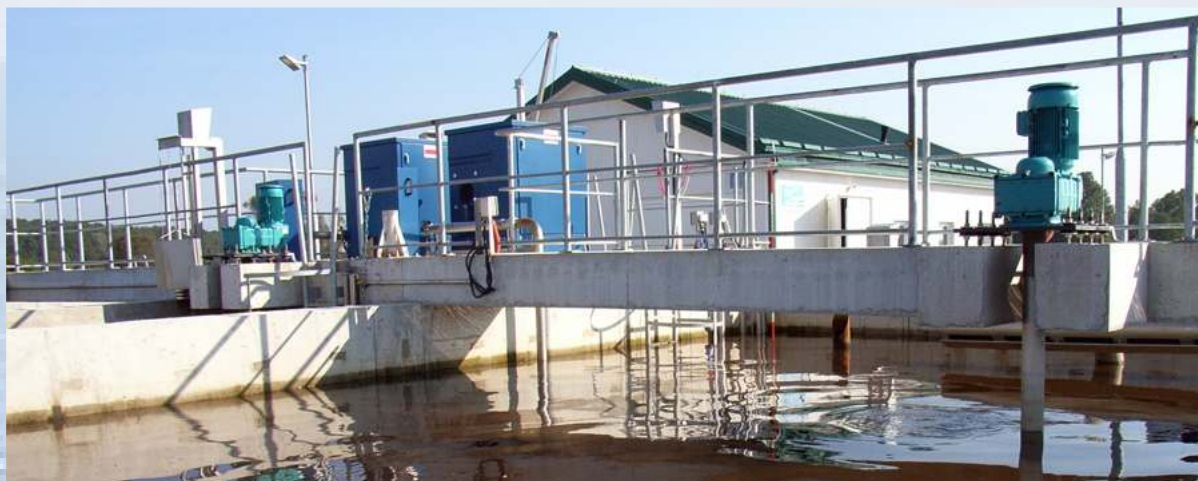
Pogled na centralnu pogonsku platformu sa upuhivačima zraka pomoću okretnih klipova.
