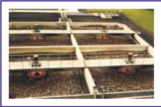
Kläranlage/WWTP Luzern (Schweiz - Switzerland)
