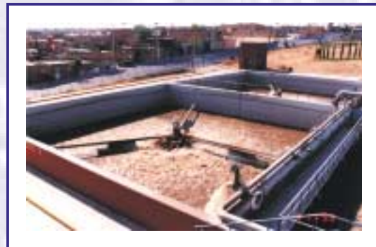
Kläranlage/WWTP Los Gringos (Mexico)
