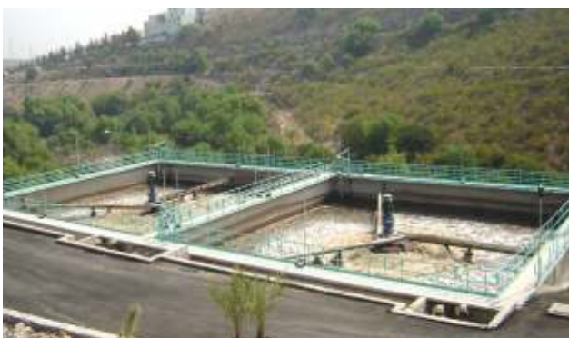
SBR-Kläranlage Stadt Celaya, Mexiko
