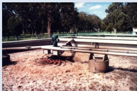
BSK®-Oberflächenbelüfter der SBR-Kläranlage der mexikanischen Stadt Celaya.
