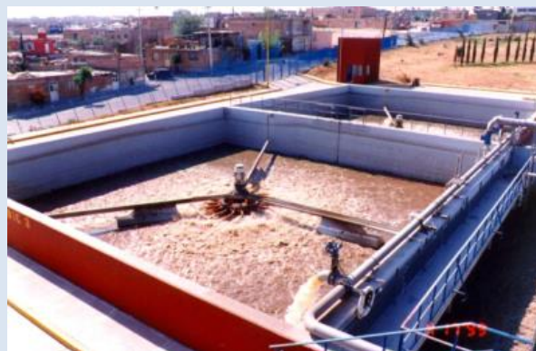
Seit 1995 arbeitet die Kläranlage für die eine mexikanische Stadt (Aguascalientes) basierend auf der Technologie der Biogest International GmbH (schwimmende Belüfter in insgesamt 5 SB-Reaktoren). Der Anschlusswert liegt bei 40.000 EW.
