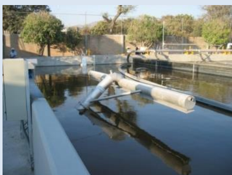
BSK®-Klarwasser-Dekanter installiert in einer Kläranlage in Mexiko
