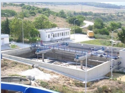
Biogest-Kläranlage von der bulgarischen Stadt Beloslav (20.000 EW).
