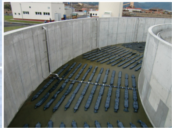
Installation von feinblasigen Tellerbelüftern (einschließlich Schutzabdeckung vor der Inbetriebnahme)
