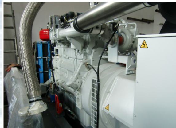
Blockheizkraftwerk zur Erzeugung von Strom aus dem Faulgas
