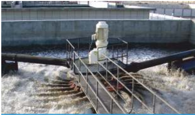
Depuradora de la ciudad de Amreya, Egipto
