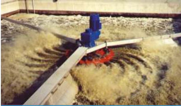
Depuradora SBR, Ayuntamiento de Krzyz, Polonia
