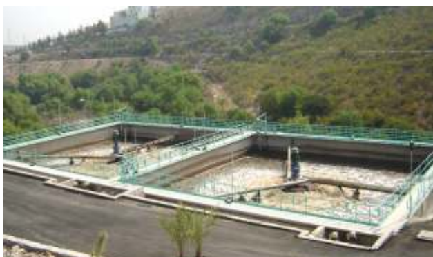
Depuradora SBR de la ciudad de Celaya, México
