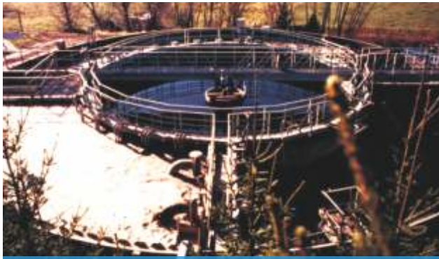
Depuradora de la cervecera Rothaus AG, Alemania
