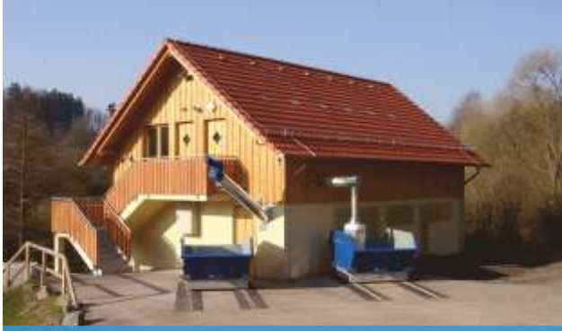
Instalación SBR, Ayuntamiento de Bubach, Alemania
