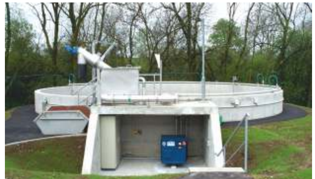
Instalación SBR, Ayuntamiento de Bösleben, Alemania
