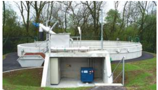
Installation SBR commune Bösleben, Allemagne
